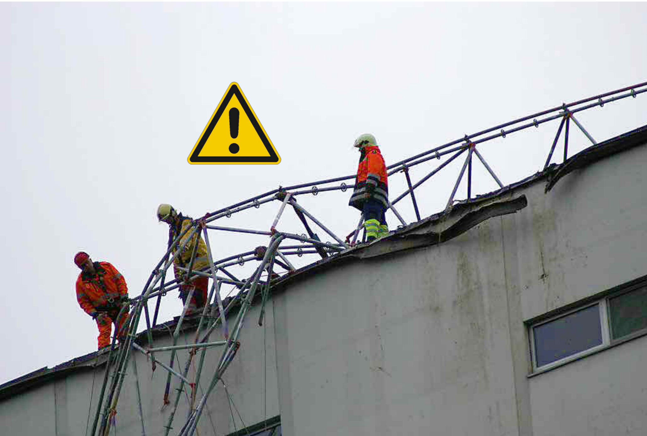
Gefahreninventar: Sturmböen, labiles Bauteil, Nässe, potenzielle Sturzhöhe 40m (Bild eines Passanten)
