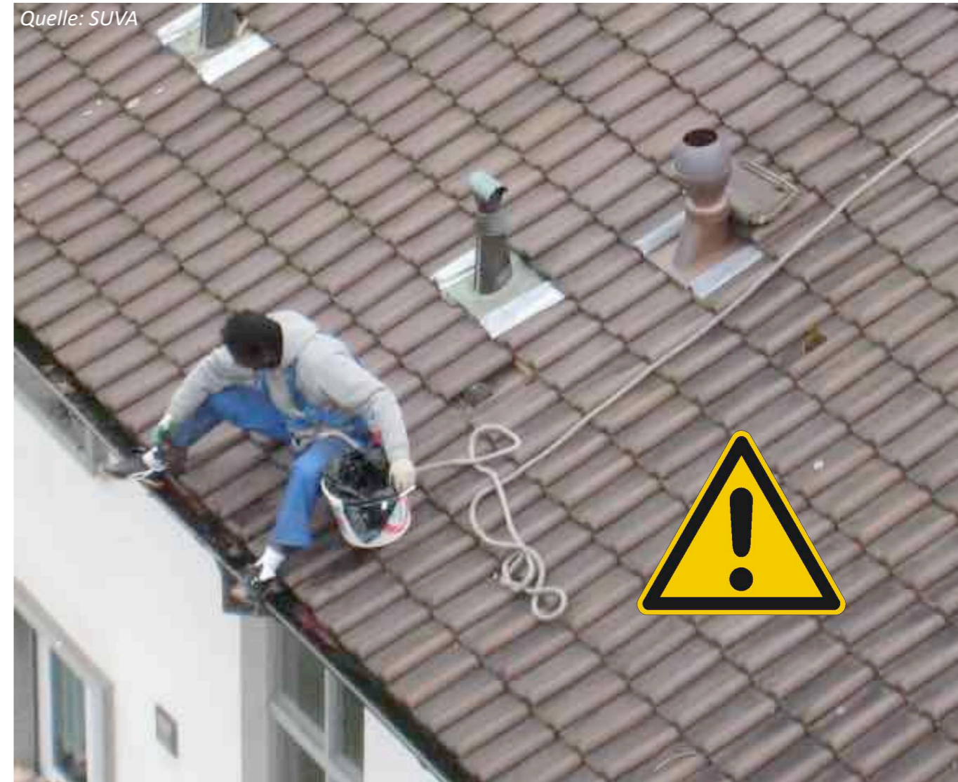
Ein Sturz würde zu äusserst schweren Verletzungen führen
